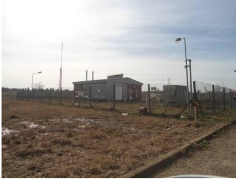
LPG Tesisi ve Doğalgaz basınç düşürme istasyonu
