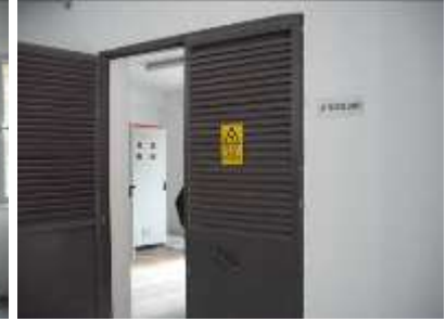
Ağ Dağıtım Odası
