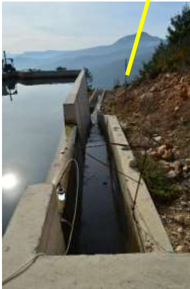
TAŞMA TAHLİYE KANALI
